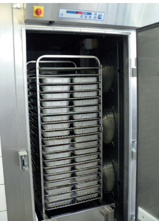
Bei der Schulverpflegung bestehen häufig Defizite, die meisten Probleme bereitet das Einhalten der Kühlkette (im Bild: Kühlen von Speisen im Chiller)
